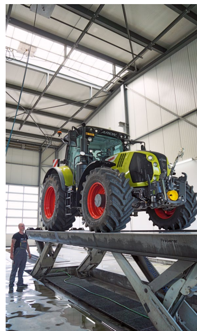
L'installation de lavage industrielle avec deux ponts élévateurs.
